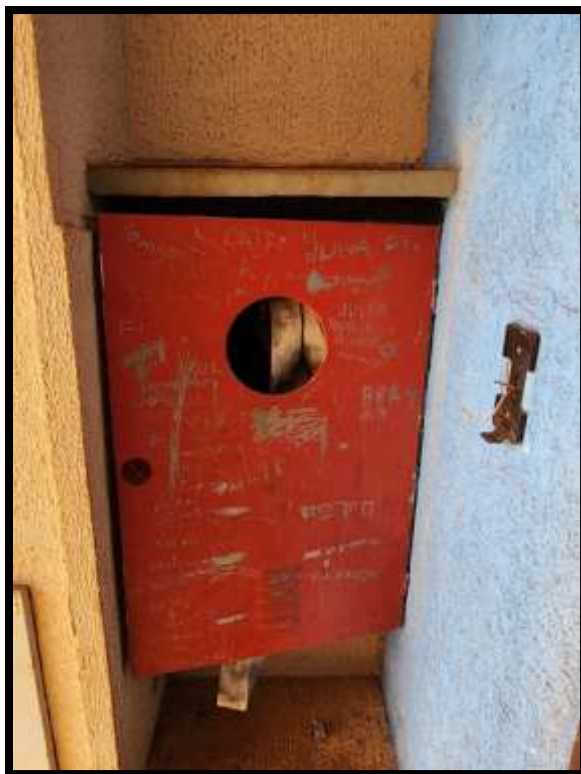
QUADRO PARA HIDRANTE DE INCÊNDIO
