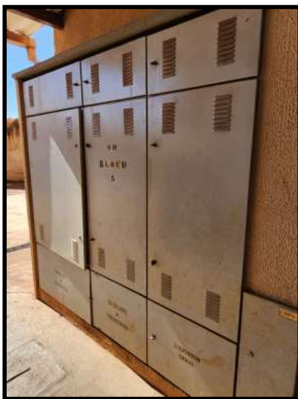
QUADRO DE RELÓGIOS DE ENERGIA ELÉTRICA INDIVIDUALIZADOS PARA CADA APTO
