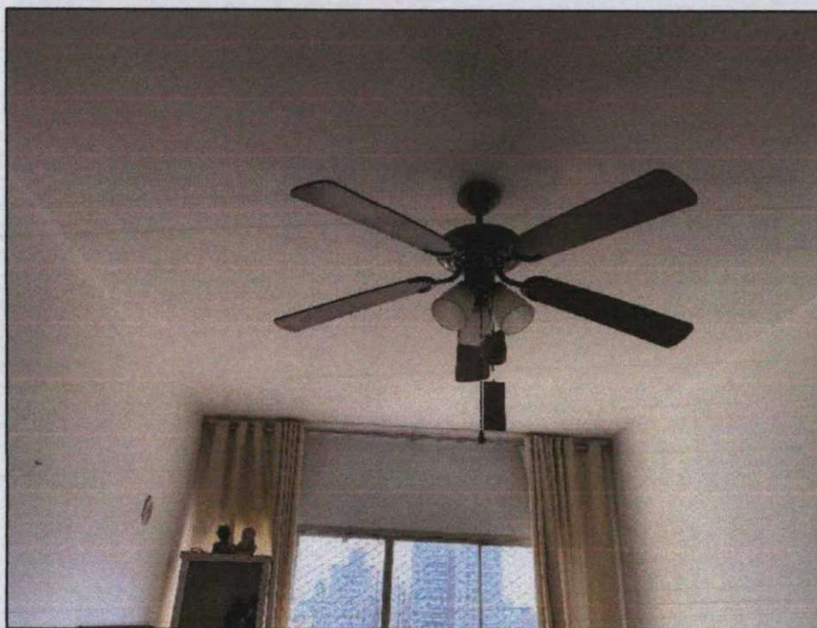
Foto 02. Detalhe do teto da sala.
