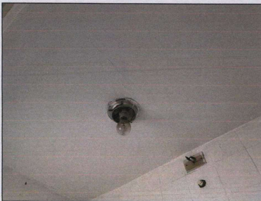
Foto 16. Detalhe do teto do banheiro de serviço.
