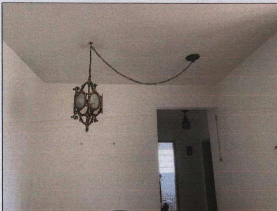
Foto 05. Detalhe do teto da sala.
