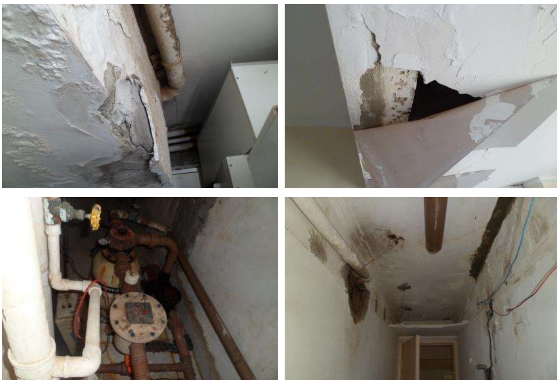
FOTO 27 – Vista de ambientes com patologias construtivas afloradas, denunciado o estado de conservação da unidade autônoma avalianda.
