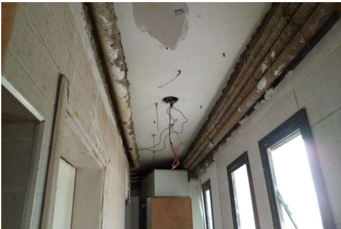
FOTO 16 – Vista do forro na área de serviços, observando tubulações da rede hidráulica expostas.
