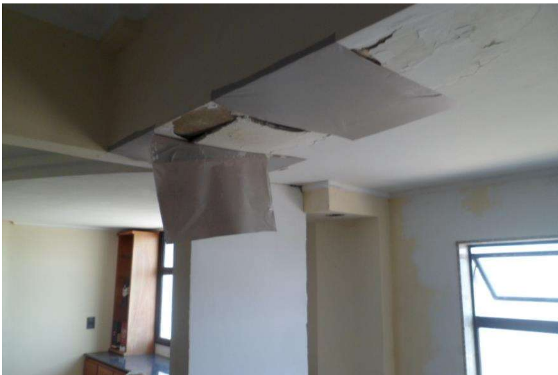
FOTO 18 – Vista interna da unidade autônoma, com deslocamento do forro em gesso.
