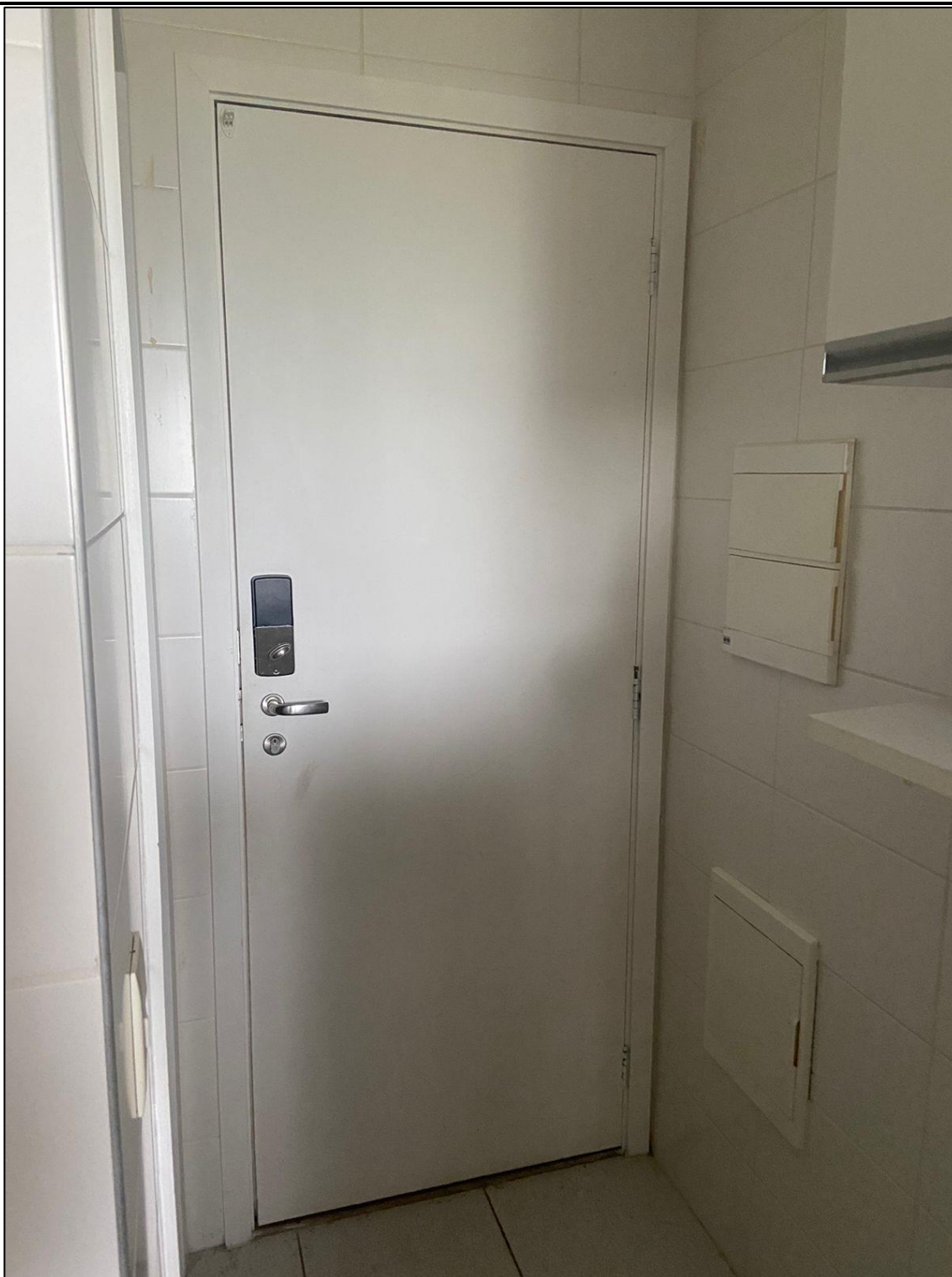
Imagem 15 – Porta de entrada de serviço (vista interna) – com fechadura eletrônica.
