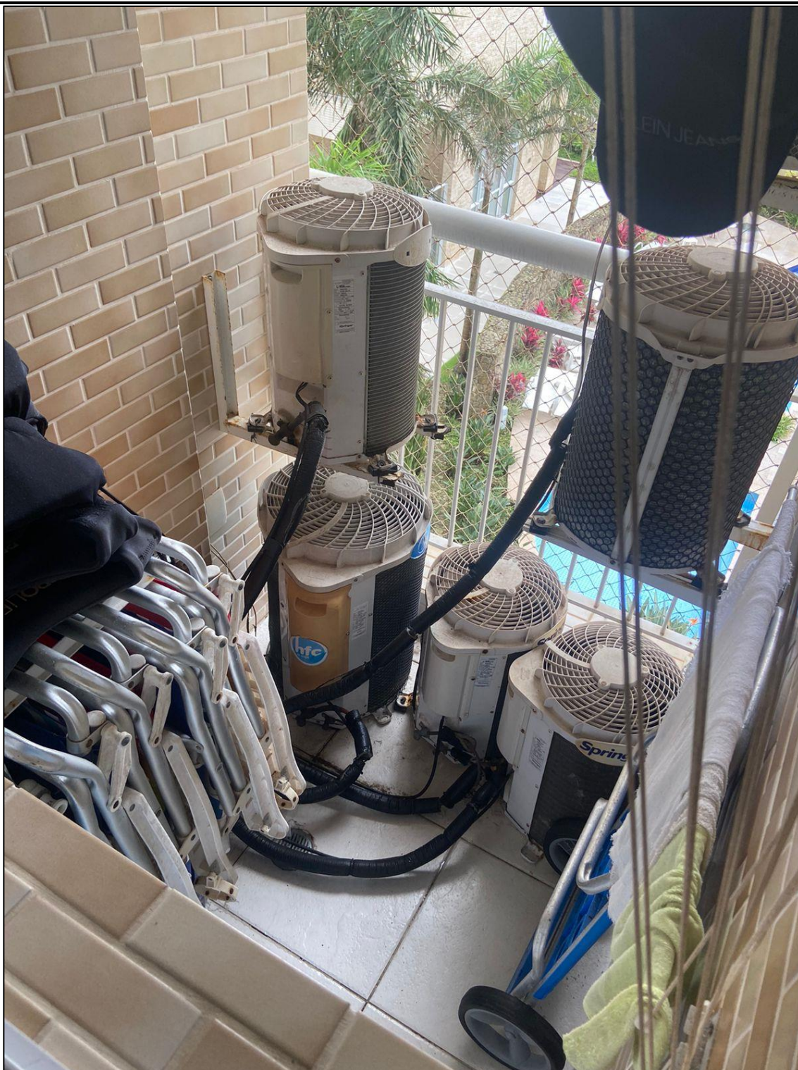
Imagem 20 – Área técnica com condensadoras de ar-condicionado.
