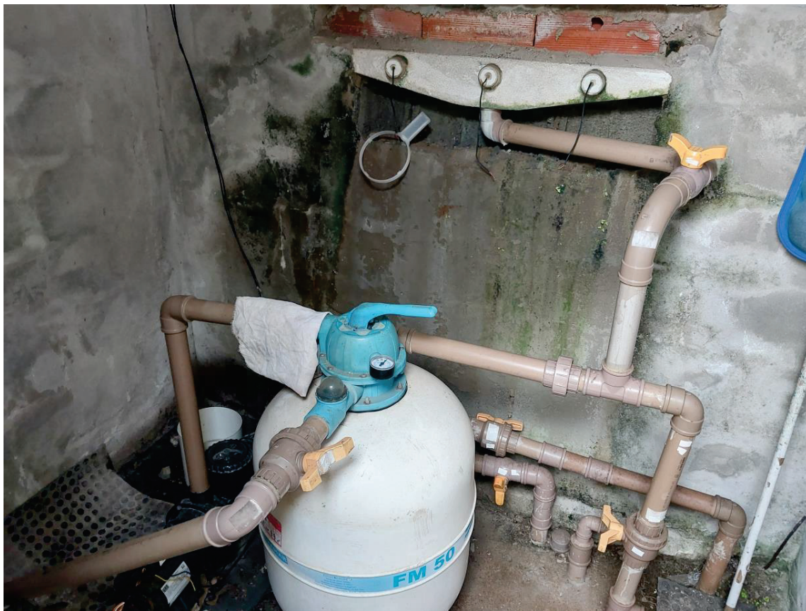
Foto 28: Casa de bombas da piscina.
