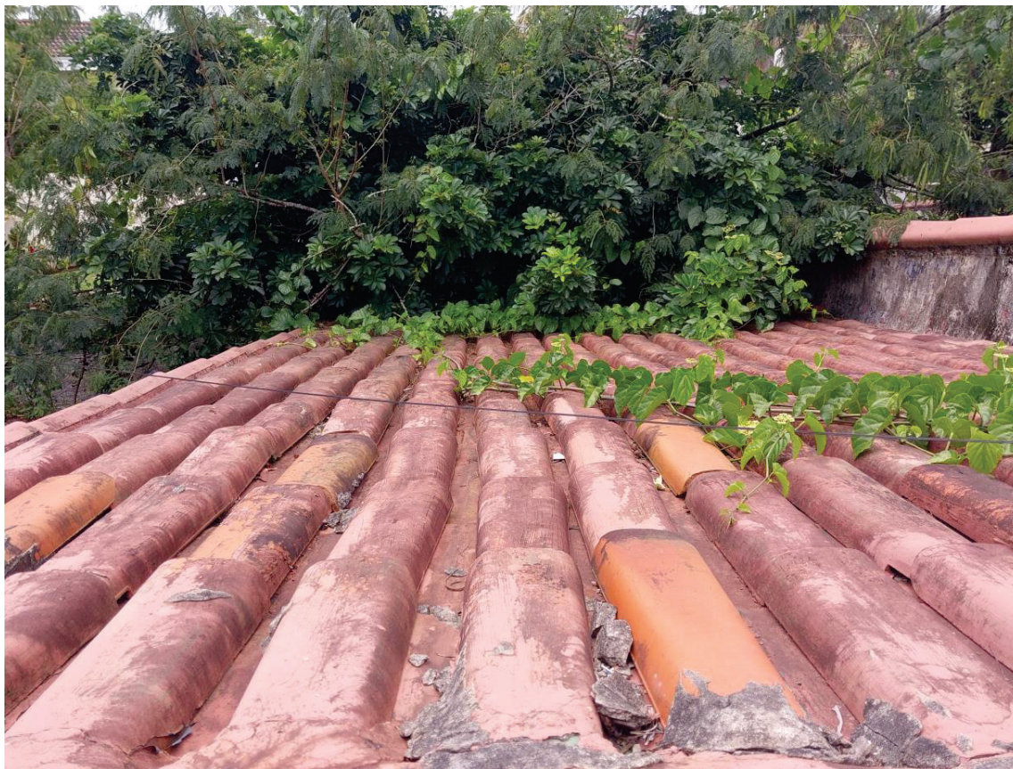
Foto 34: Condições de manutenção dos telhados – Semicríticas.
