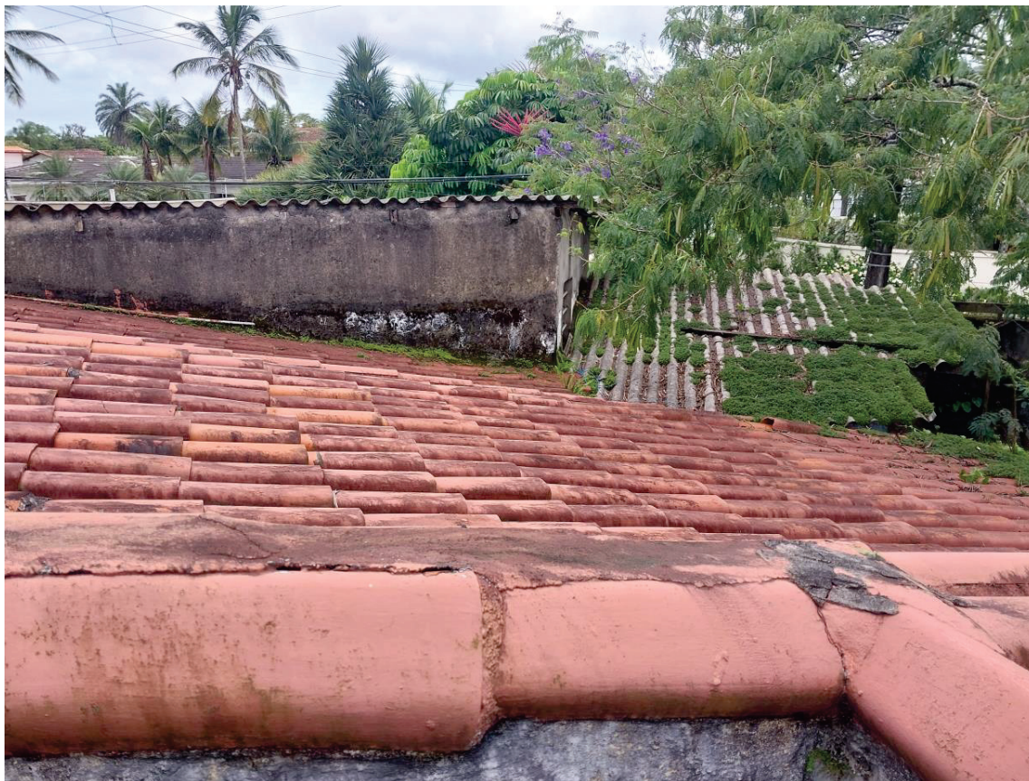
Foto 35: Condições de manutenção dos telhados – Semicríticas.
