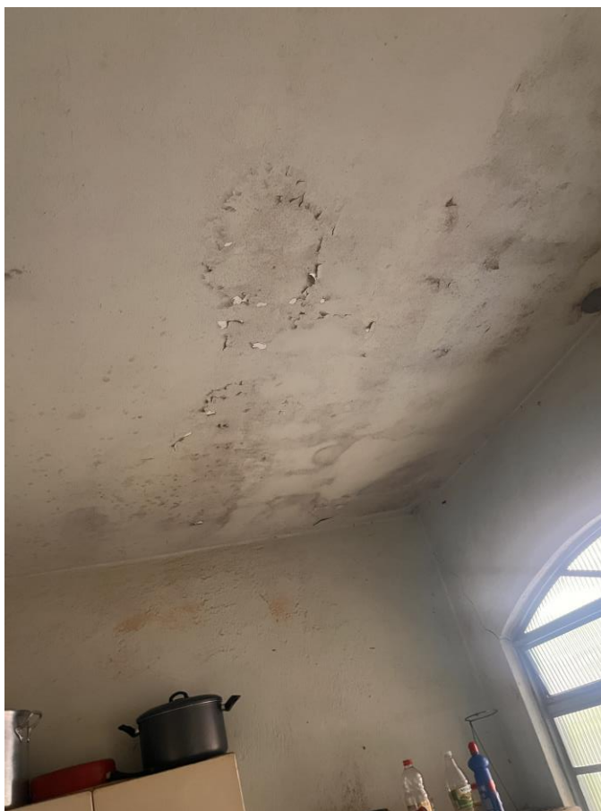
Fig. 15 Detalhe do teto da cozinha com bastante umidade.
