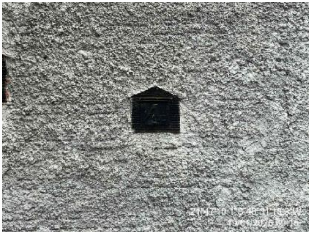
MEDIDOR DE ENERGIA
