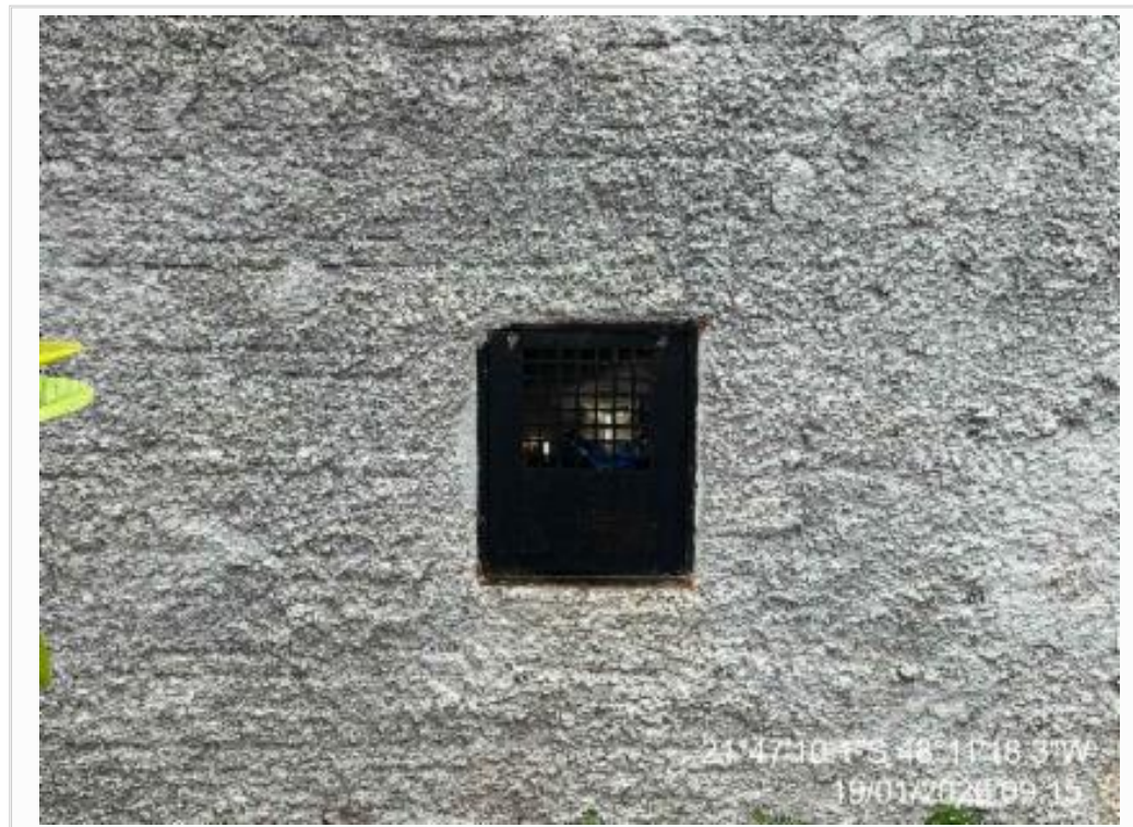
MEDIDOR DE ÁGUA
