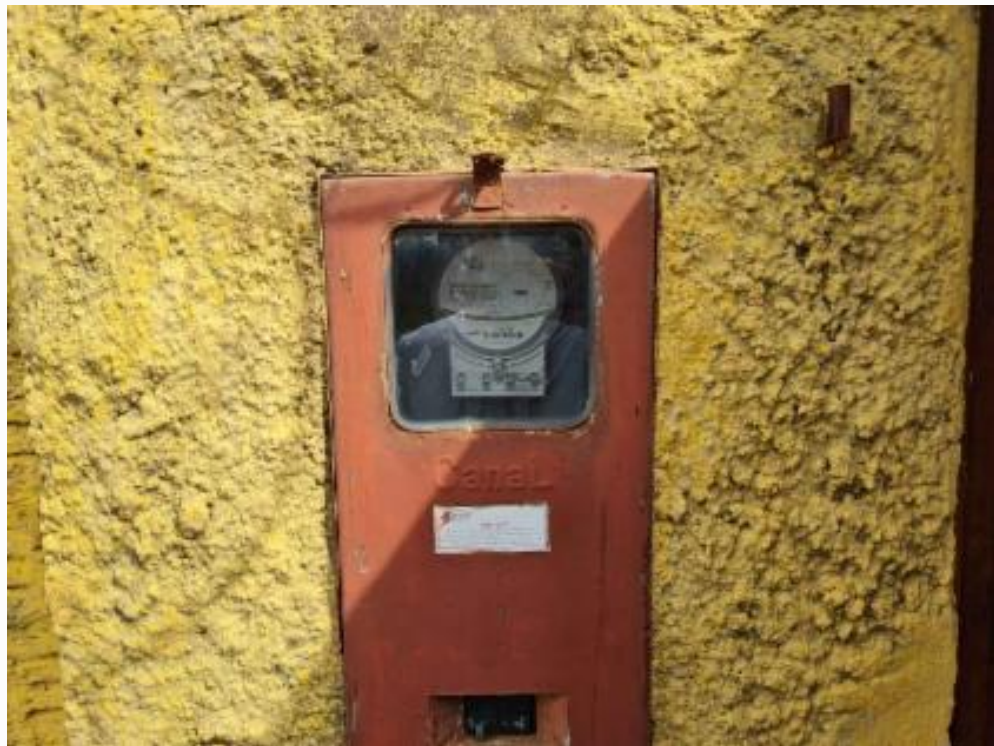
Quadro de energia
