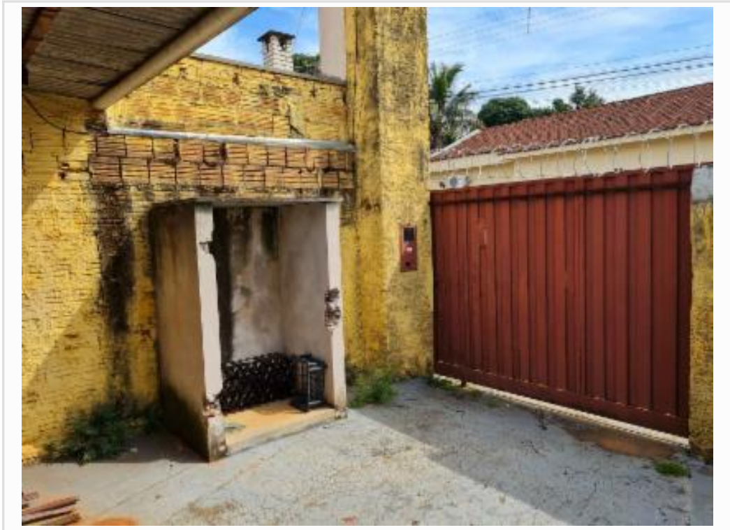
Casa de gás e portão de acesso
