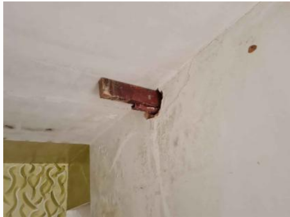
Ripa da cobertura transpassando laje e parede (sala de acesso principal)
