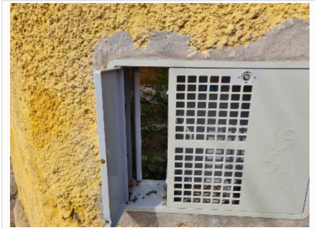
Caixa da Sabesp (não possui ligação de água ativa)
