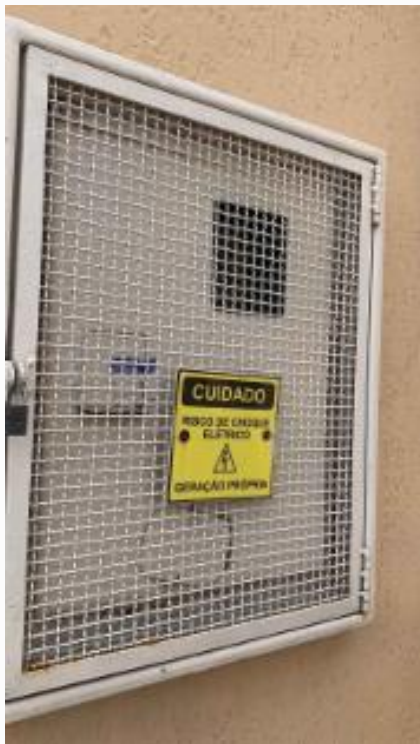
Medidor de energia
