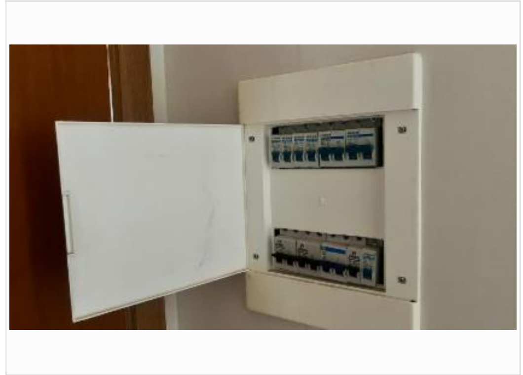
Quadro de distribuição
