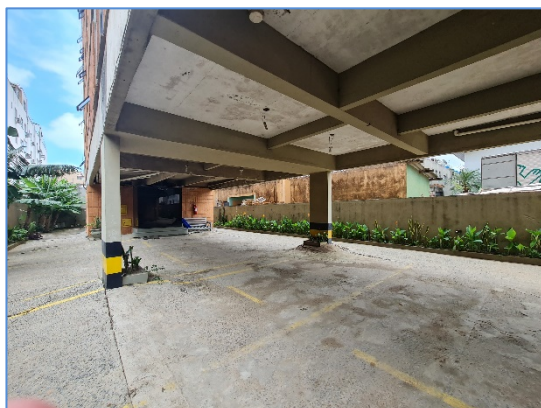
Foto 7 – Vista geral do piso da garagem com afundamento generalizado
