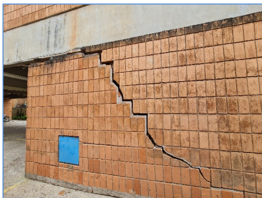
Foto 3 – Fenda no bloco A
