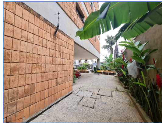
Foto 4 – Vista da garagem do térreo e afundamento do piso
