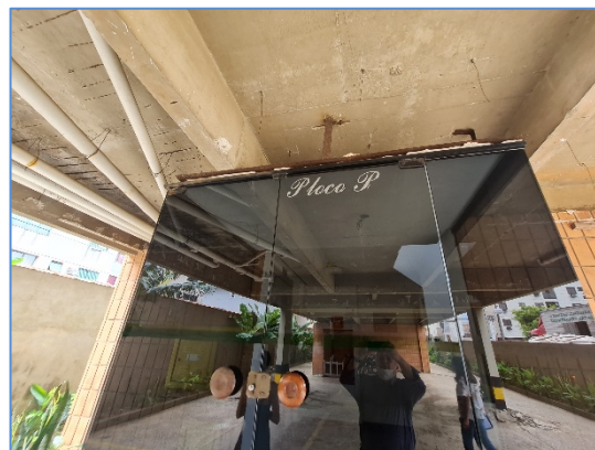
Foto 8 – Vista da entrada ao bloco B. Notar corrosão de armadura no teto.
