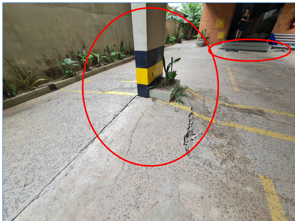
Destaque a foto 5: notar afundamento severo do piso do pavimento térreo
