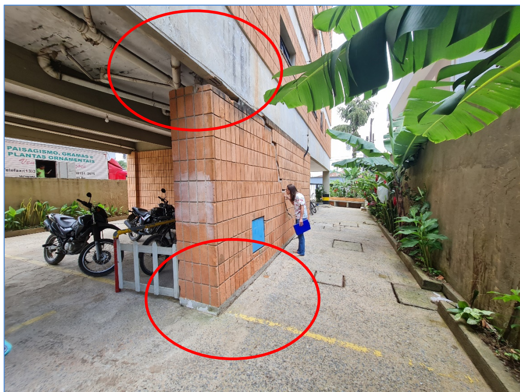
Destaque da foto 6: Fenda, afundamento de piso e possível movimentação do bloco A causado pelo recalque
