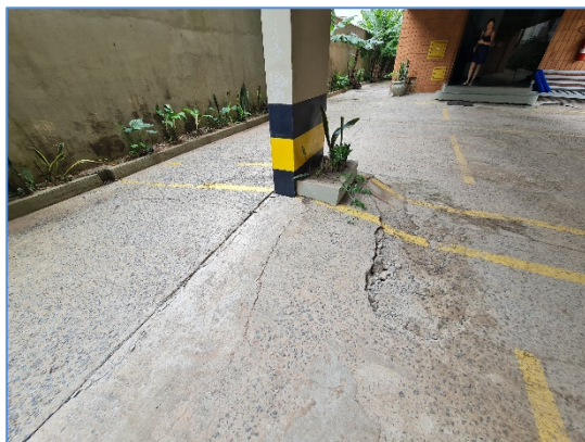
Foto 5 – Detalhe do afundamento de piso no térreo junto a entrada do Bloco B
