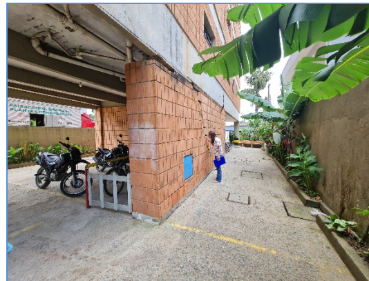
Foto 6 – Vista da garagem do térreo e fenda junto ao bloco A
