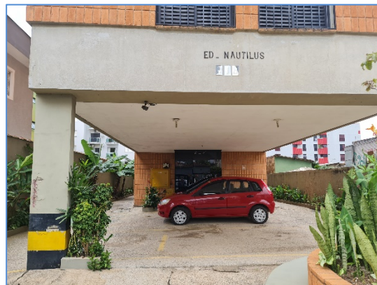
Foto 2 – Vista do pavimento térreo, que sofreu afundamento de piso generalizado
