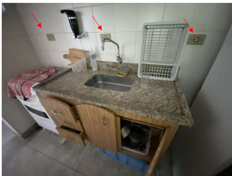
Imagem 16 - Detalhe para tomadas obsoletas.
