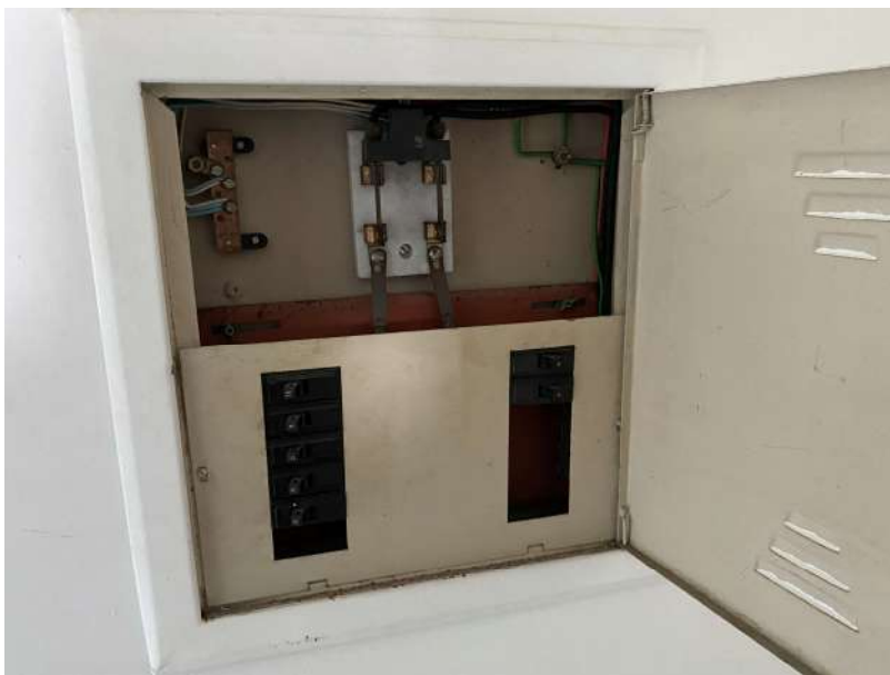
Imagem 20 - Vista do quadro de energia do apartamento, com instalações elétricas obsoletas.
