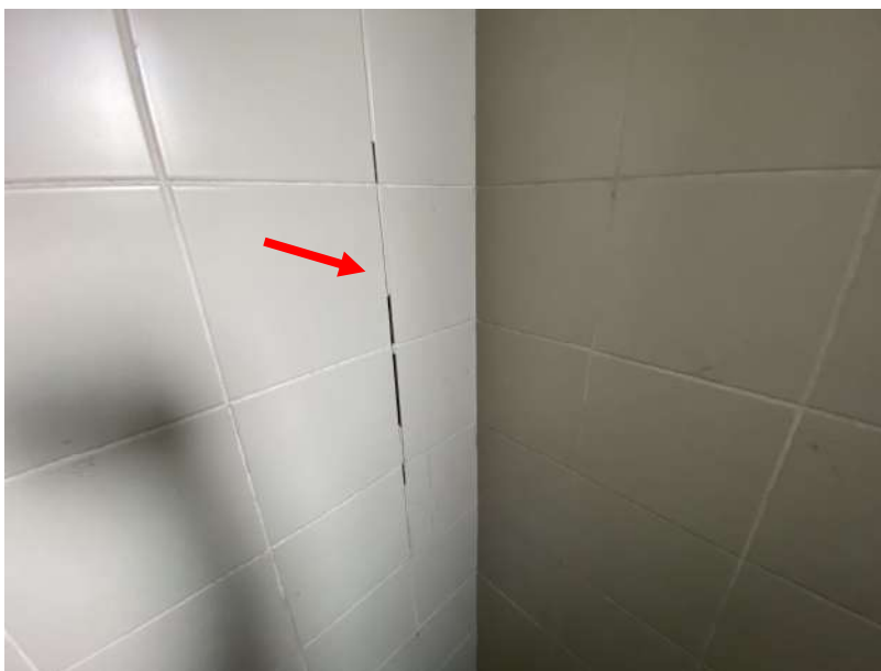
Imagem 19 - Vista de descolamento pontual de peças cerâmicas da área de serviço do apartamento avaliando.
