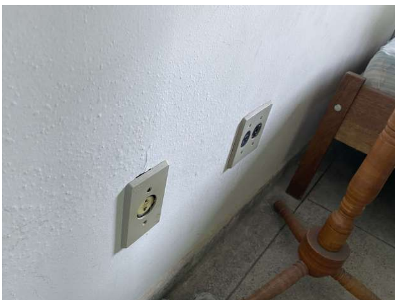
Imagem 26 - Detalhe para deterioração da pintura das paredes do dormitório.
