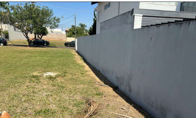
Foto 08. Vista da divisa a esquerda do lote sem muro de arrimo
