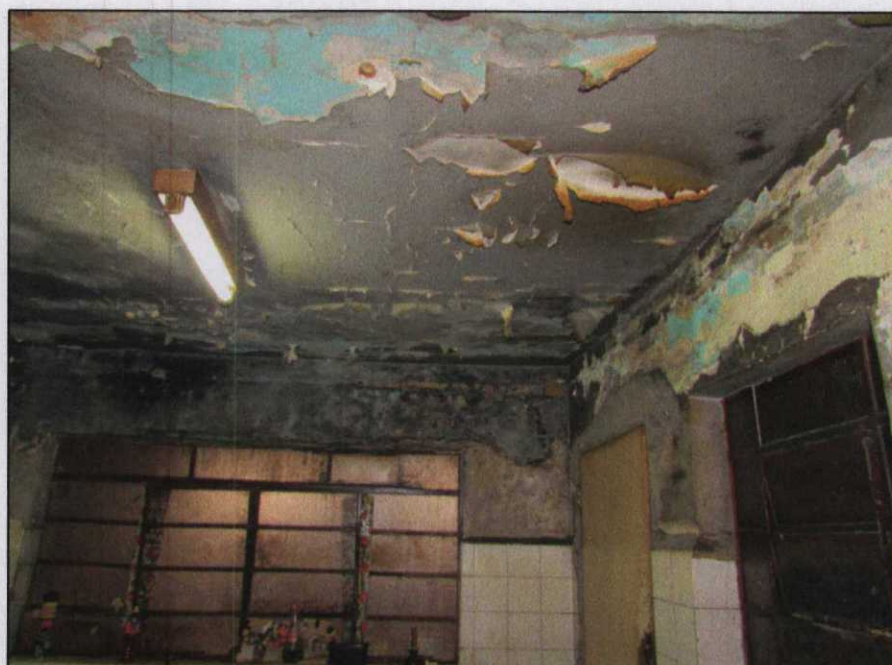
Foto 08:.. Cozinha com piso cerâmico, paredes revestidas com azulejo até meia altura, caixilhos em ferro. Em péssimo estado de conservação.
