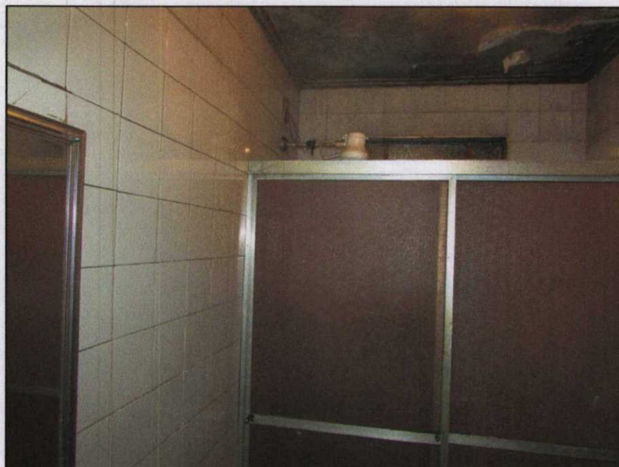
Foto 10:.. Banheiro com piso cerâmico, paredes revestidas com azulejo até o teto, caixilhos em ferro. Em péssimo estado de conservação.
