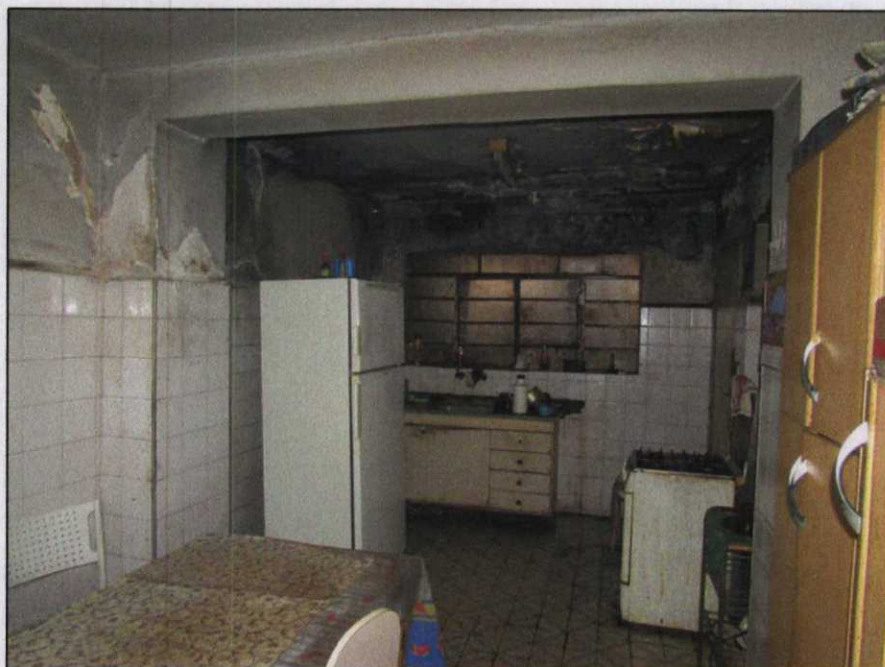
Foto 07:.. Cozinha com piso cerâmico, paredes revestidas com azulejo até meia altura, caixilhos em ferro. Em péssimo estado de conservação.
