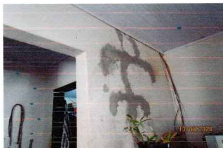
FOTO N° 6 Vista interna do dormitório - paredes e forro
