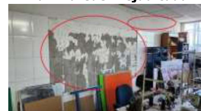
2º Pav. Parede Prejudicada
