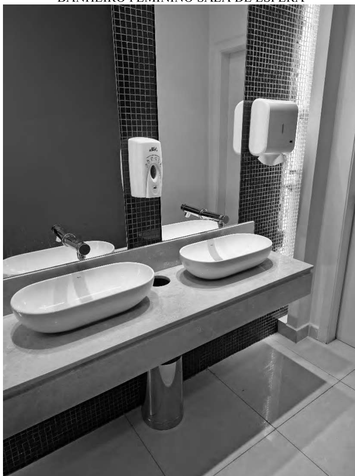
LAVATÓRIOS SALA DE ESPERA
