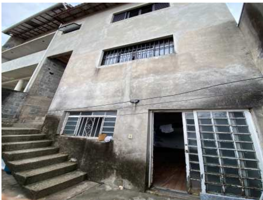
Fotos que demonstram a escada lateral externa de acesso ao pavimento inferior e a falta de acabamento e pintura faltante.
