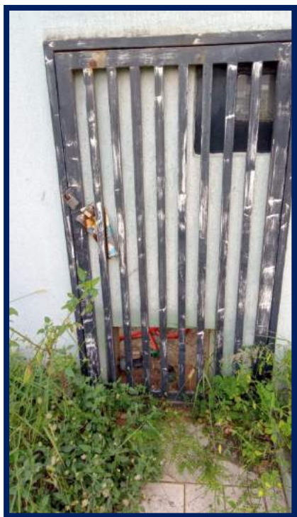
Acesso para leitura de água e energia (Lote nº 07).
