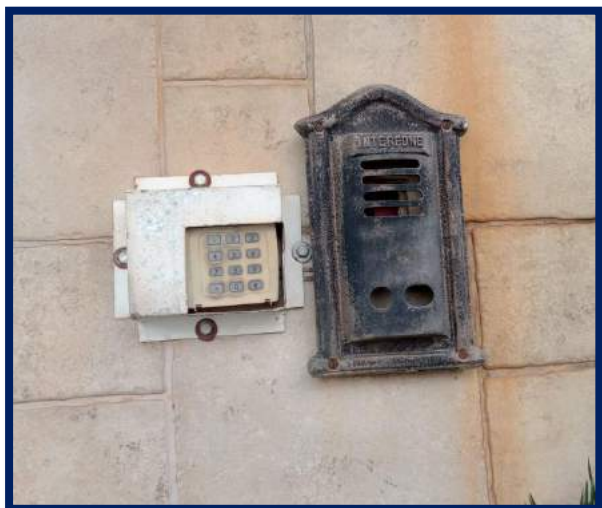
Controle para entrada e abertura do portão automático com senha e espaço para alocação de interfone (Lote nº 07).
