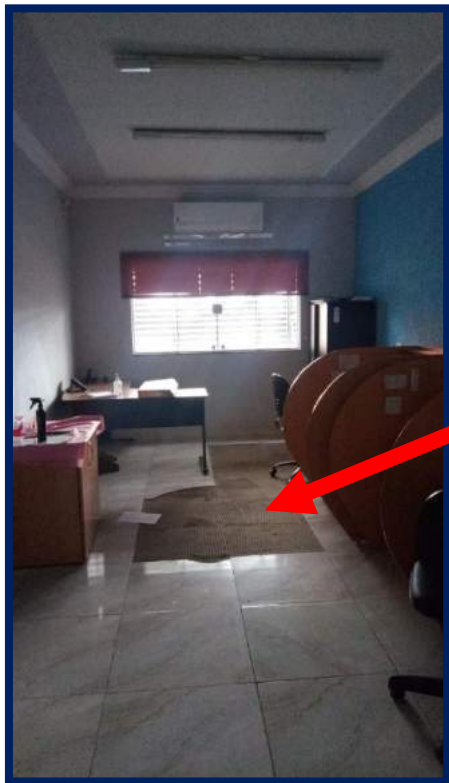
VISTA DO HALL, COM DETALHE PARA OS PISOS QUEBRADOS (LOTE Nº 08).
