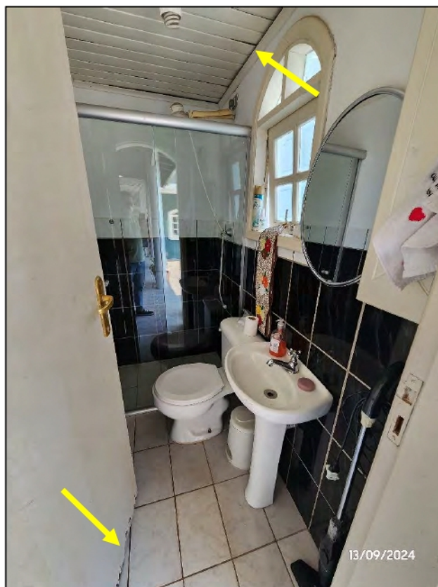
FOTOGRAFIA Nº 07: Vista geral do banheiro. Detalhe para os danos no revestimento da esquadria (porta) e forro.
