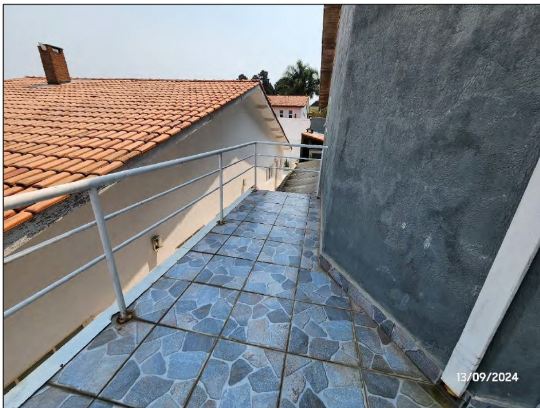
FOTOGRAFIA Nº 24: Detalhe dos danos no revestimento do piso e alvenaria – dormitório 3.
