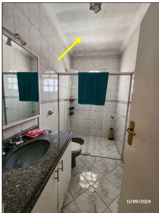
FOTOGRAFIA Nº 21: Vista geral do banheiro – suíte 1. Detalhe das manchas no revestimento do forro.
