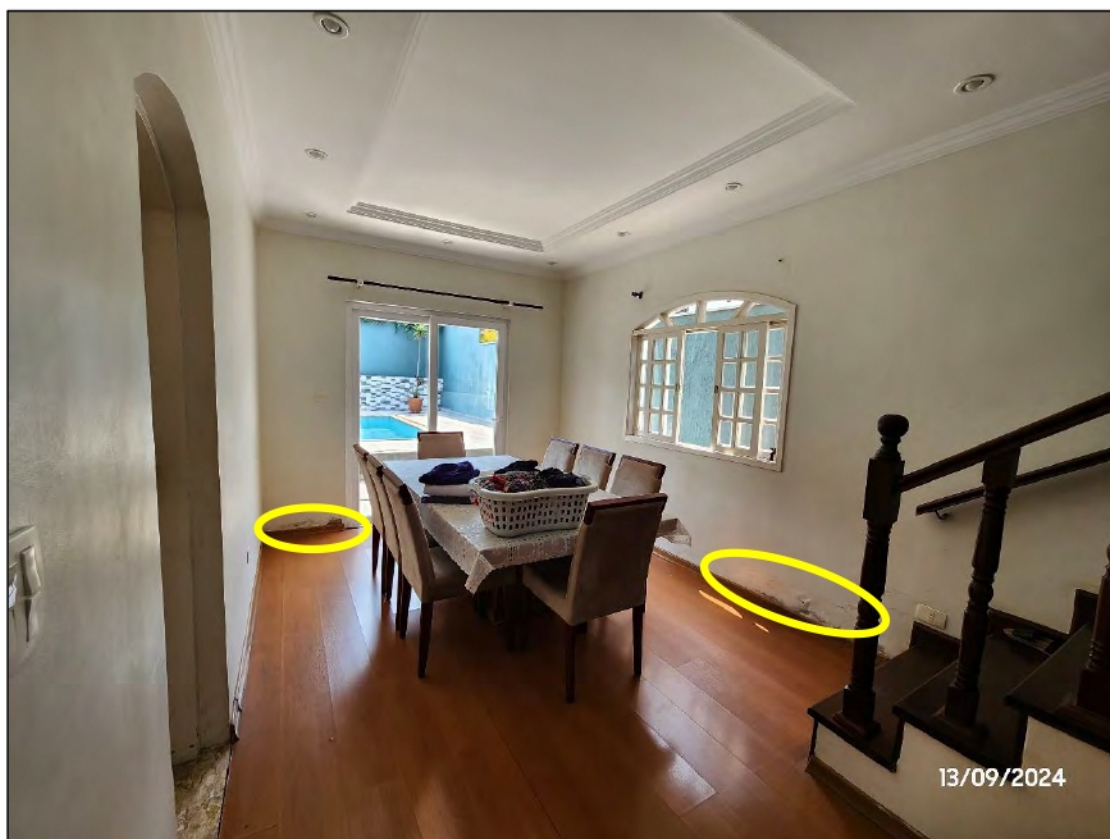
FOTOGRAFIA Nº 13: Vista geral da sala de jantar. Detalhe para as manchas de umidade no revestimento da alvenaria.
