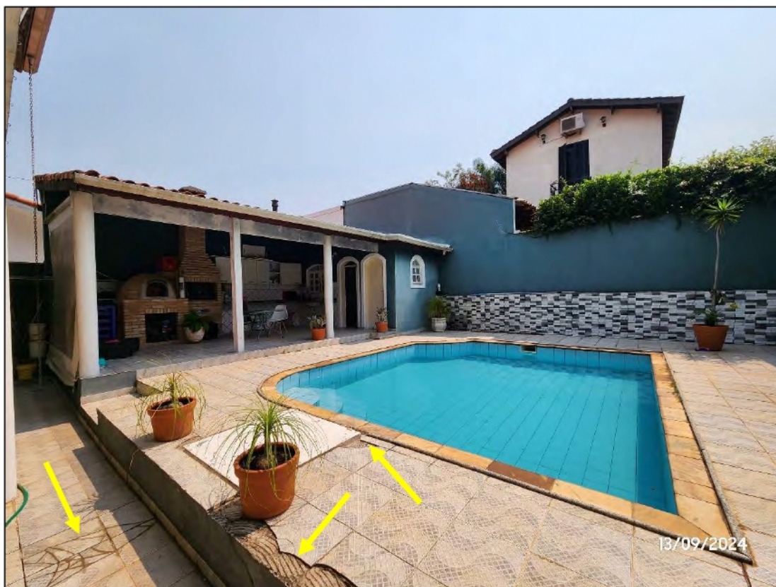
FOTOGRAFIA Nº 06: Vista geral da área da piscina e churrasqueira. Detalhe das trincas e deslocamento do revestimento do piso.
