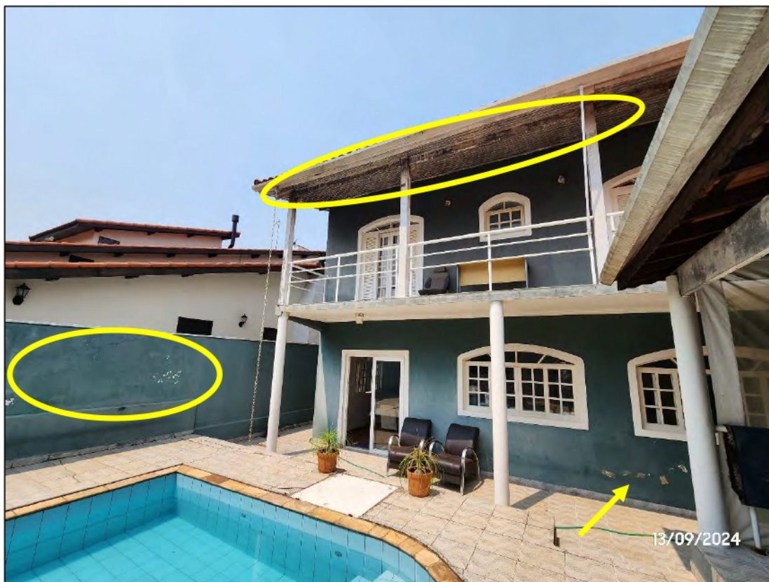
FOTOGRAFIA Nº 05: Vista geral da área externa. Detalhe das manchas de umidade no revestimento da alvenaria e beiral da cobertura.
