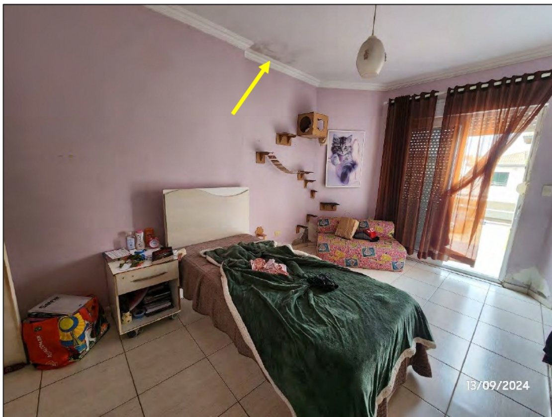
FOTOGRAFIA N° 22: Vista geral do dormitório 3. Detalhe das manchas de umidade no revestimento do forro.
