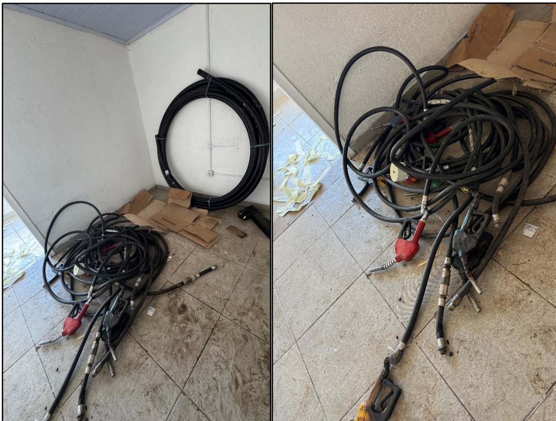
ITEM 080 - MNGUEIRAS DE BOMBAS DE COMBUSTÍVEL
