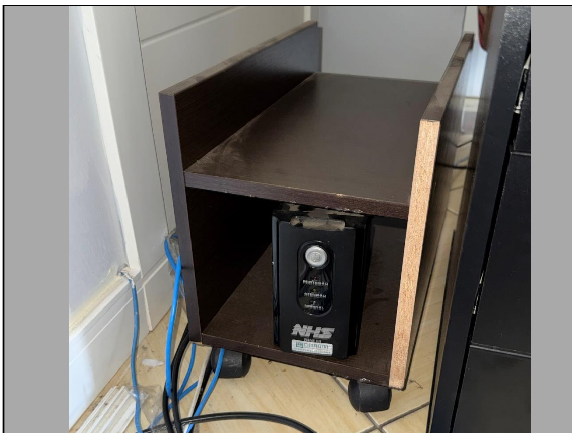
ITEM 101 - SUPORTE DE MADEIRA PARA NOBREAK C/ NOBREAK
