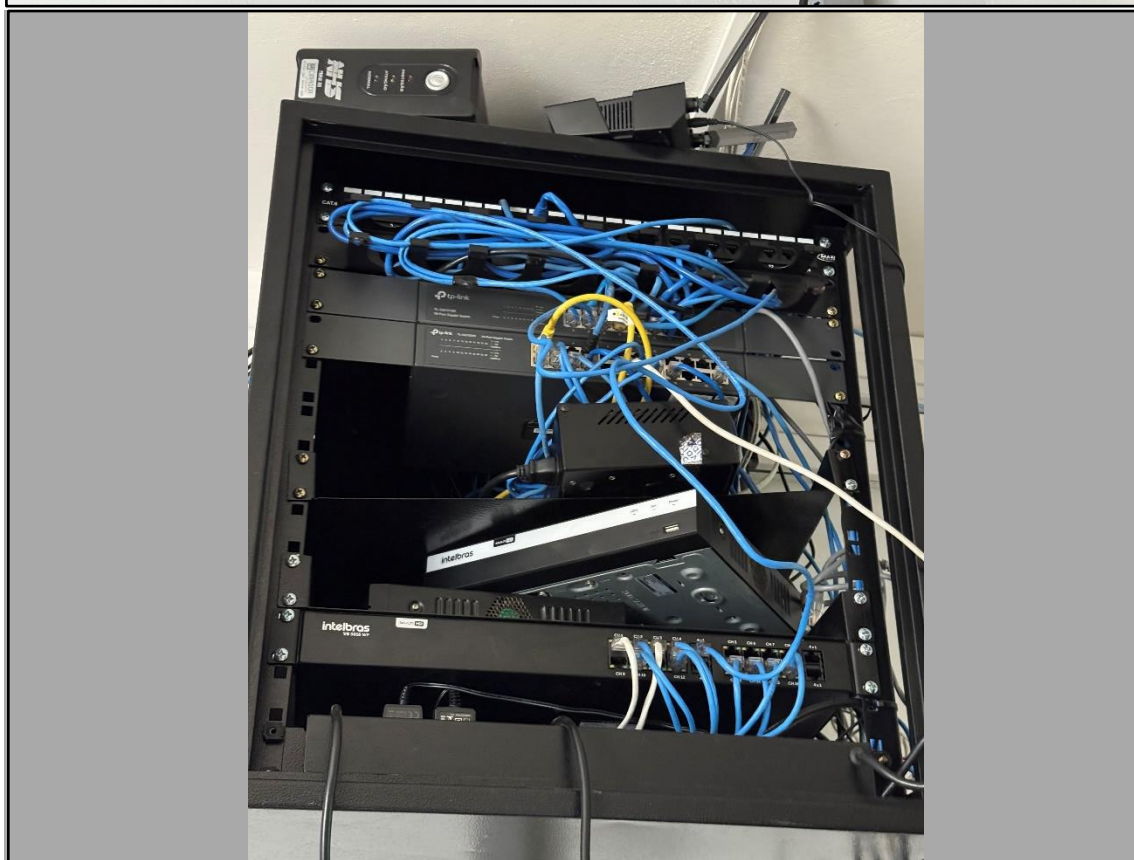
ITEM 106 AO 112 - SWITCH TP LINK, CENTRAL PABX INTELBRAS CONECTA, DVR MULT HD INTELBRAS, POWER BALUN DE 16 CANAIS INTELBRAS VB3016, MINI PC POSITIVO, NOBREAK NHS E RACK AÉREO
