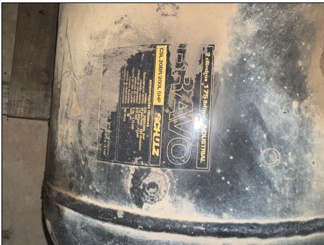
ITEM 031 - COMPRESSOR SCHULTZ BRAVO
