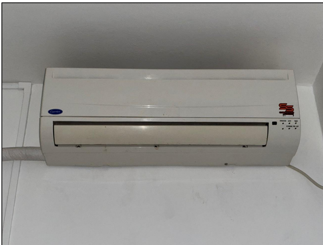
ITEM 102 - AR CONDICIONADO CARRIER
