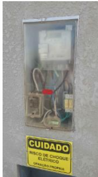
Medidor de energia
