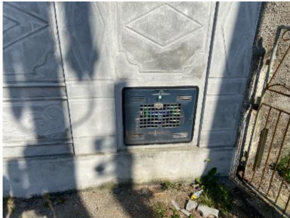
Medidor de Água
