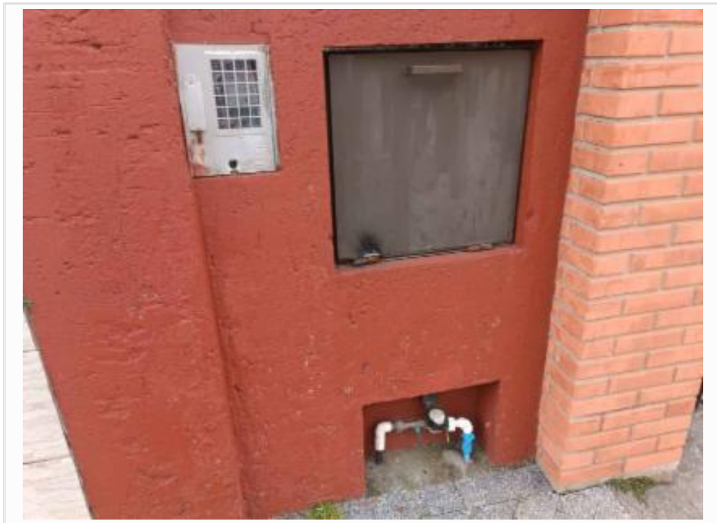
MEDIDOR DE AGUA
