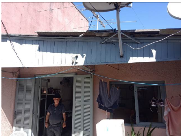
Foto 08 – Imóvel ocupado por Osvaldo
