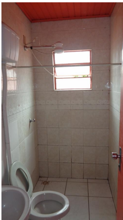
Representação Banheiro Descrição Data Foto 07/11/2017
