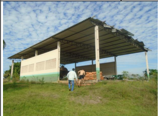
Foto 03 – Galpão em abandono
