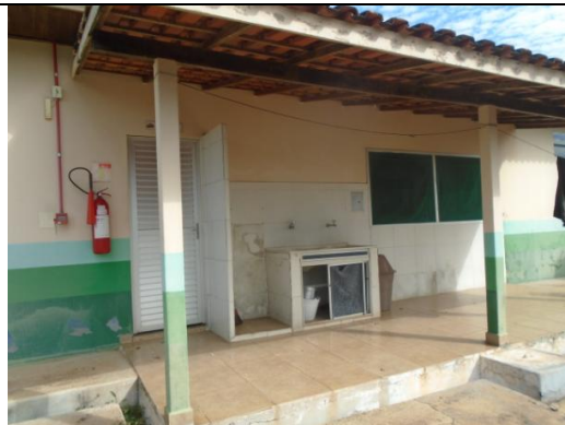
Foto 06 – Azulejo faltando e pintura desgastada.
