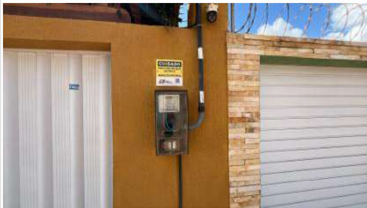
Entrada de energia.
