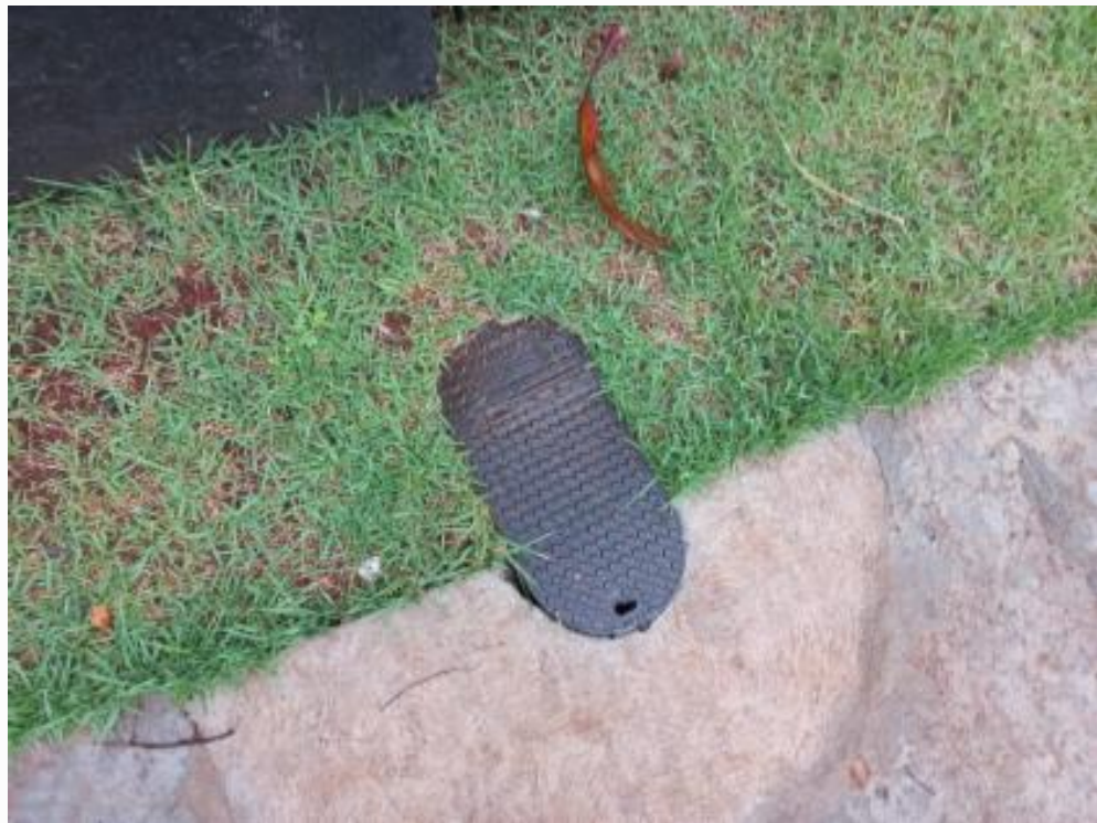
MEDIDOR DE ÁGUA
