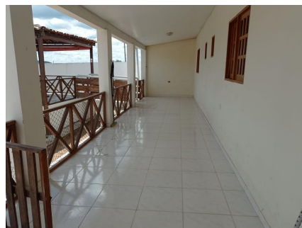
Representação Varanda / Sacada Descrição Data Foto 13/04/2022
