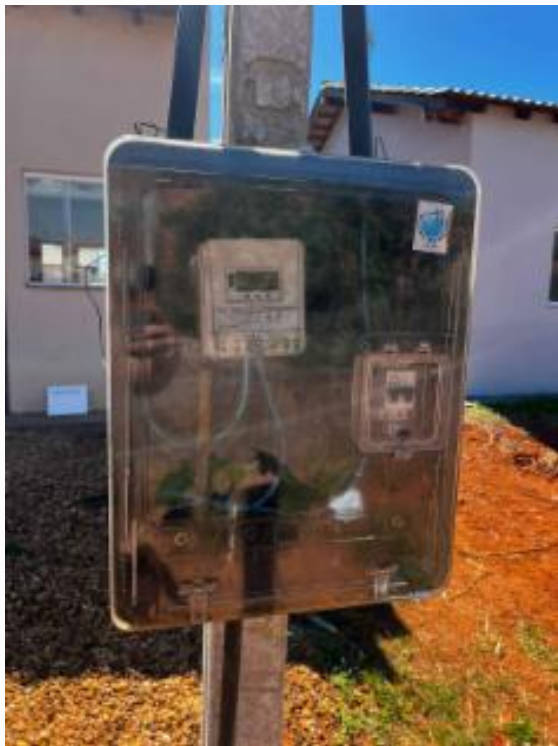
MEDIDOR DE ENERGIA
