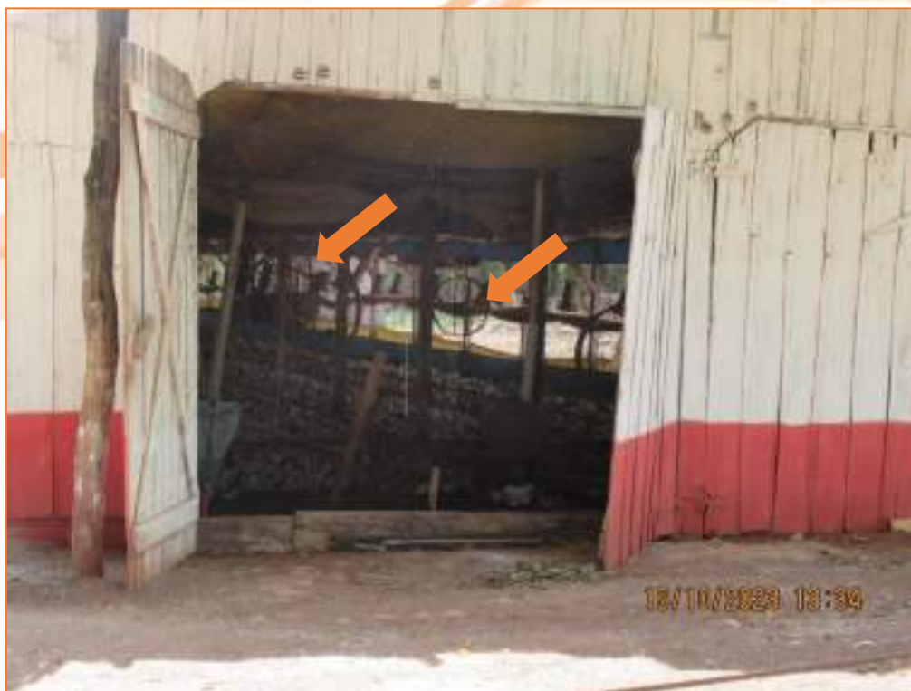
Figura 10 – Ventiladores industriais alocados dentro de um dos aviários.
