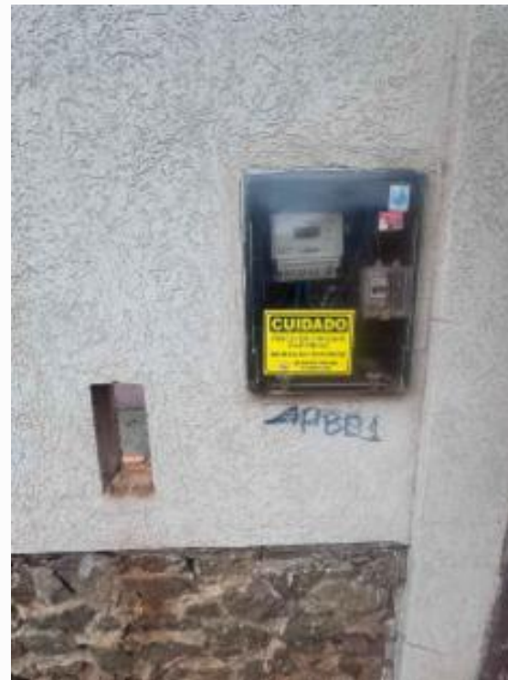
MEDIDOR DE ENERGIA
