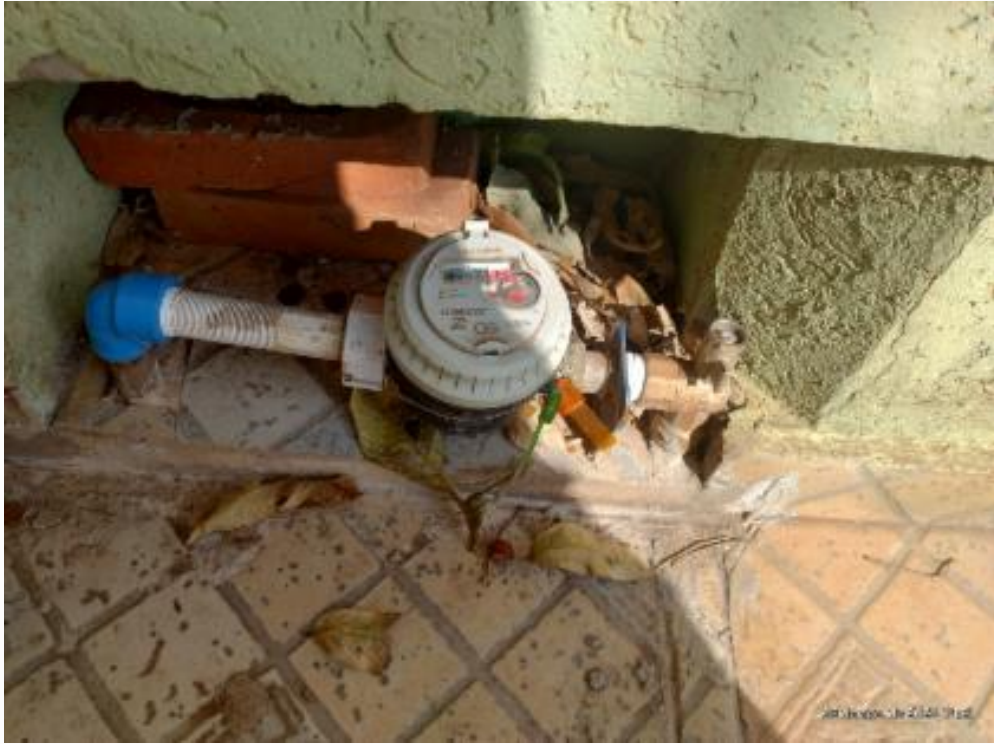
MEDIDOR DE ÁGUA
