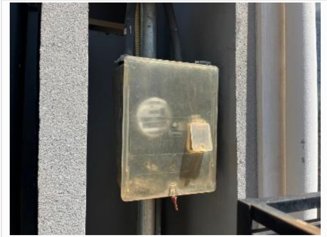
Medidor de energia
