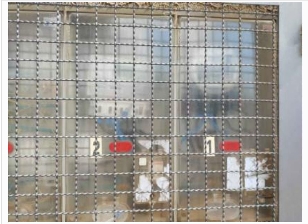
Medidor de energia
