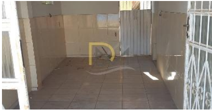
Representação Fachada Principal Descrição AMOSTRA 2 Data Foto 05/08/2024
