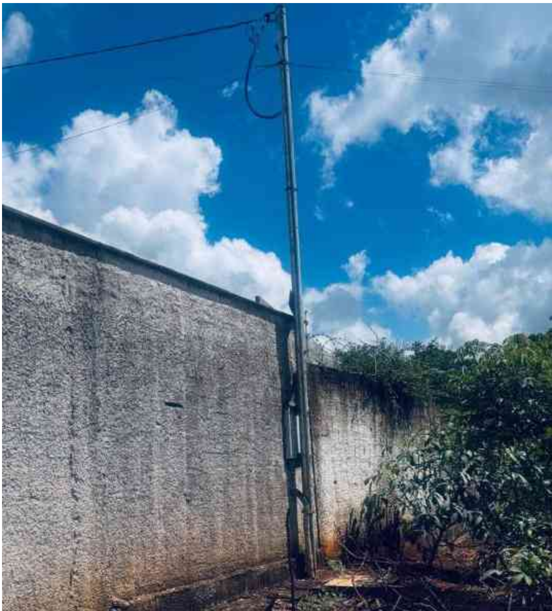
Imagem 20: Medidor de energia elétrica.
