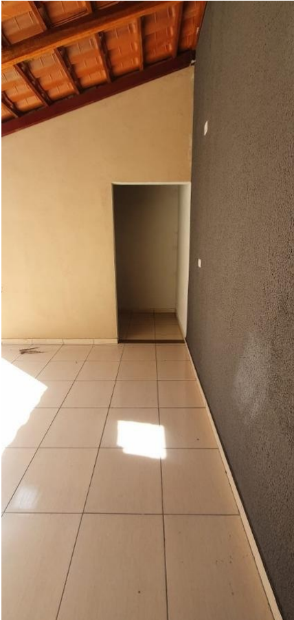
Representação Varanda / Sacada Descrição Data Foto 24/05/2022
