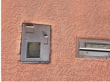
Representação Descrição Medidor de energia Data Foto 15/10/2021
