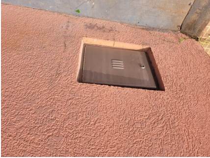
Representação Descrição Medidor de água Data Foto 15/10/2021
