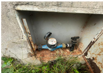
Representação Alpendre Descrição Hidrômetro Data Foto 11/04/2024
