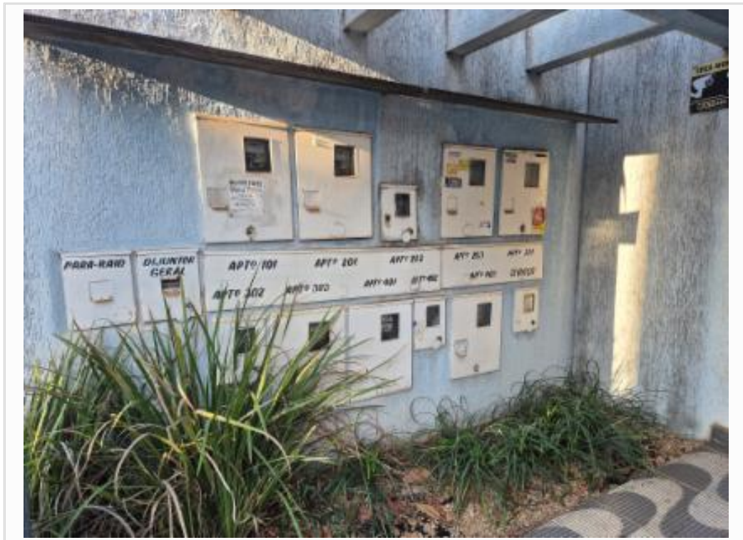
Medidores do condomínio
