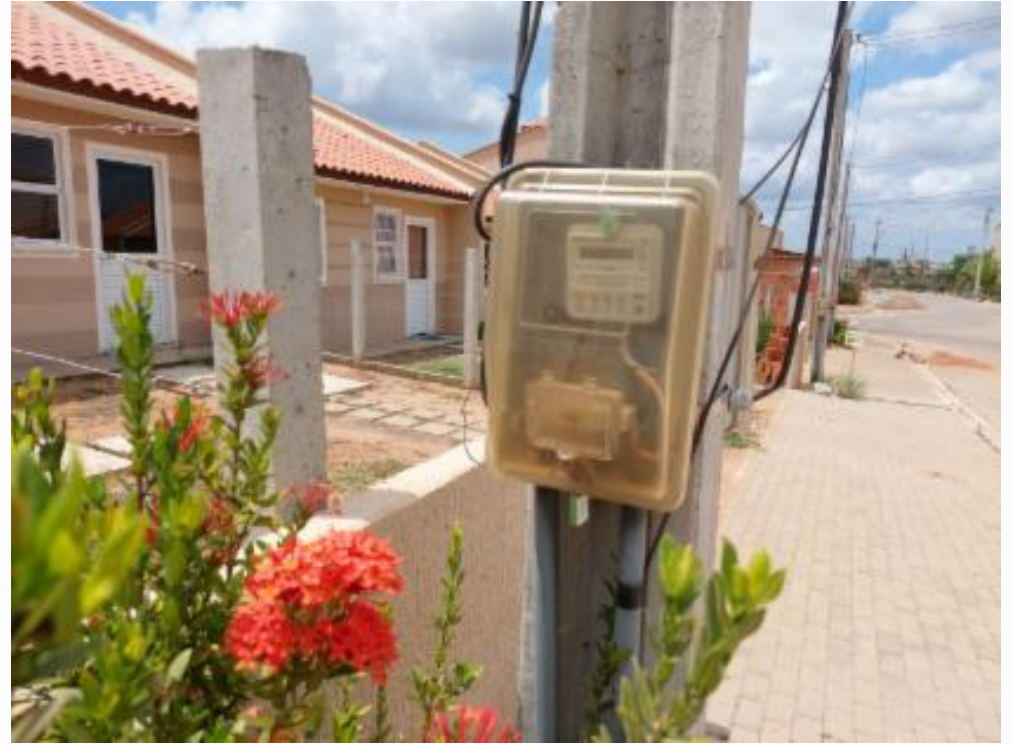
Medidor de energia
