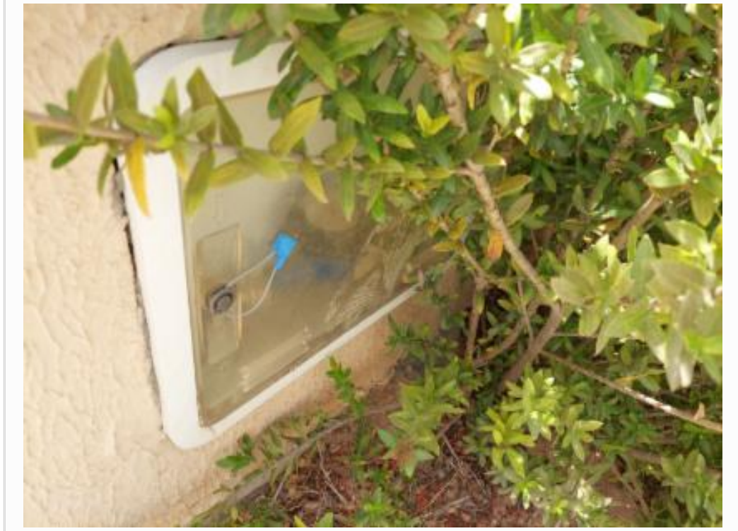
Medidor de água
