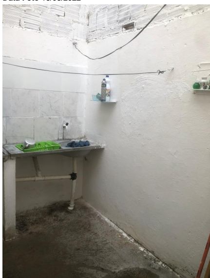
Representação Área de Serviço Coberta Descrição Vista interna da área de serviço Data Foto 16/03/2022
