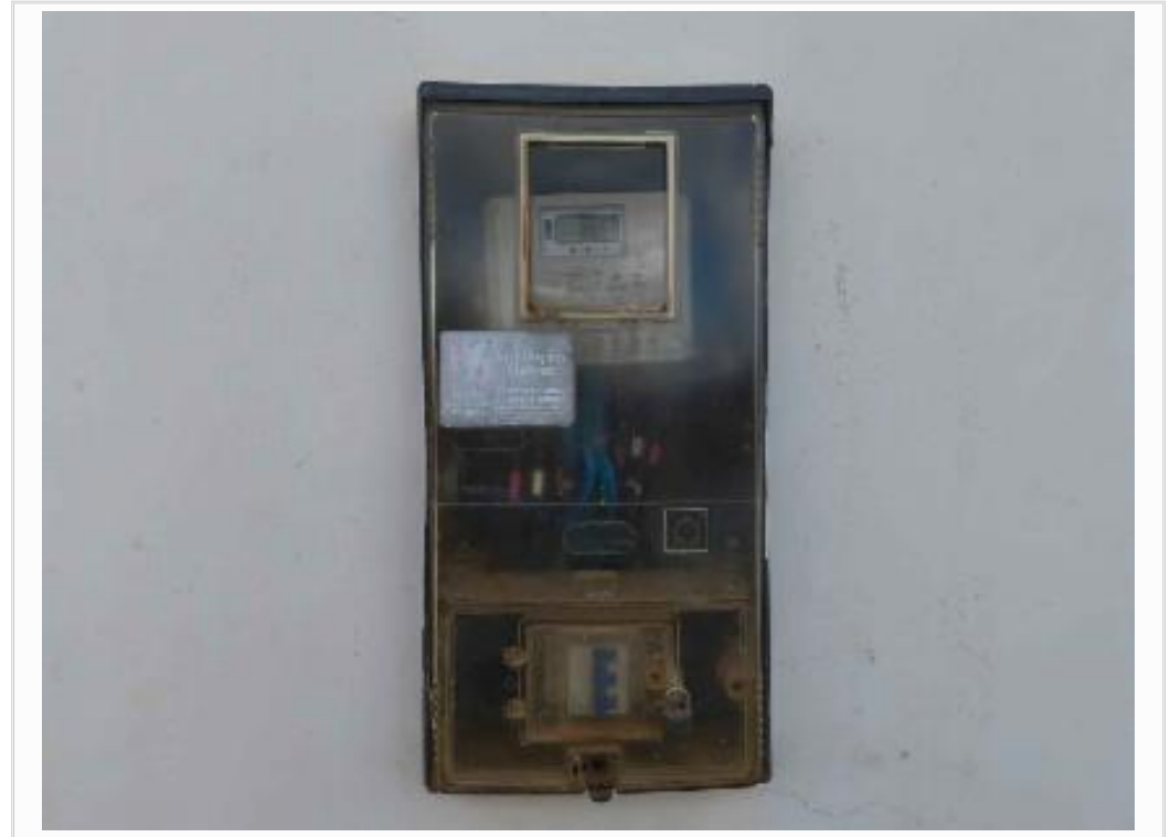
Entrada de energia
