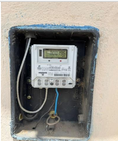
Medidor de energia
